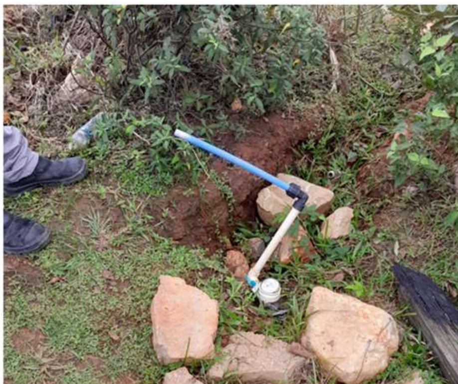
Foto 2 – Posicionamento do hidrômetro dentro da propriedade.
